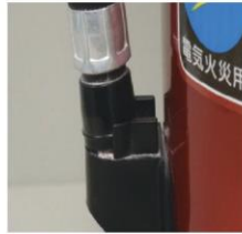
× 消火薬剤の漏れ
