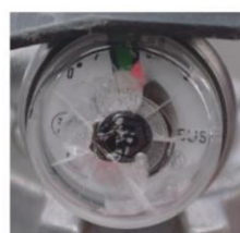
× 指示圧力計の損傷
