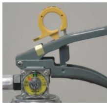
× 安全栓の抜けかけ
